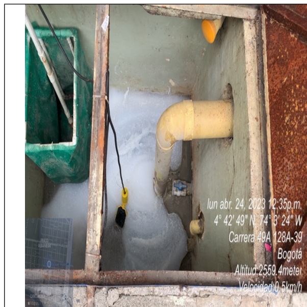
Foto No.3. Tanque homogeneizador
