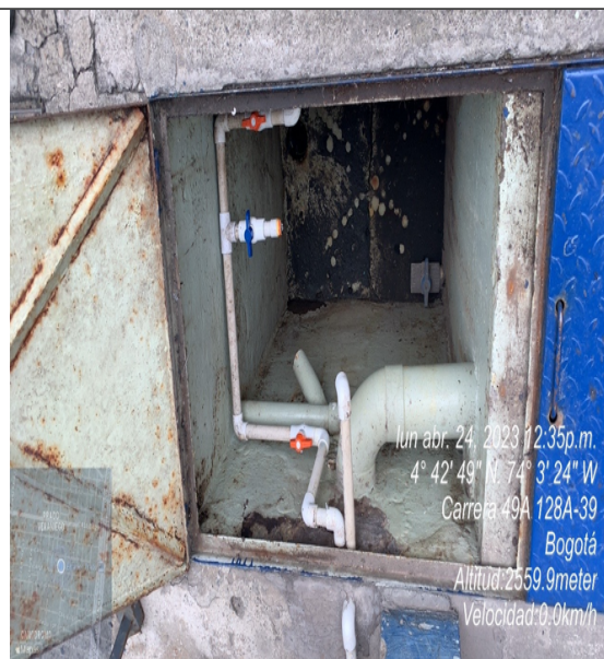
Foto No.4. Caja de inspección externa
